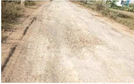
हालत बनाई गई अधिकांश सड़कें मरम्मत नहीं होने के चलते जर्जर हो गई हैं। जिससे चलते लोगों
